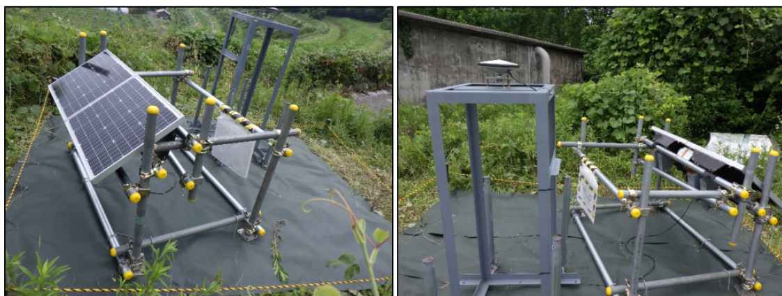
写真-1 小型 GNSS 観測点「C 萩福井上」．商用電源を使用できない山間部の野外であるため，独立電源型装置構成とした．
