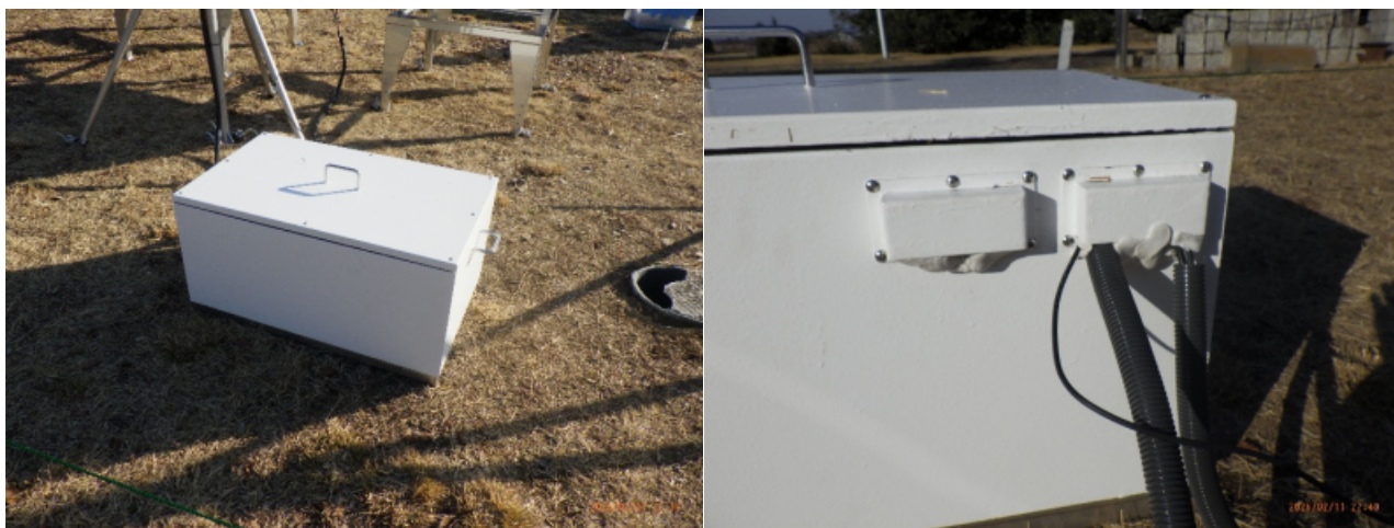
写真-4 左図は観測装置収納箱の全体写真。右図は観測装置収納箱のケーブル取出口。
