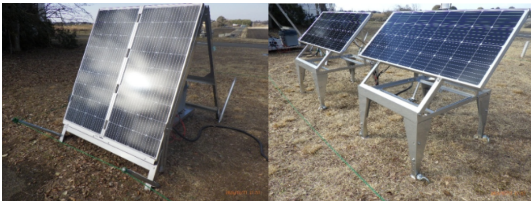
写真-3 左図は令和 6 年度に開発した観測装置・電源バッテリー設置架台。右図は令和 7 年度に開発した電源設置架台。
