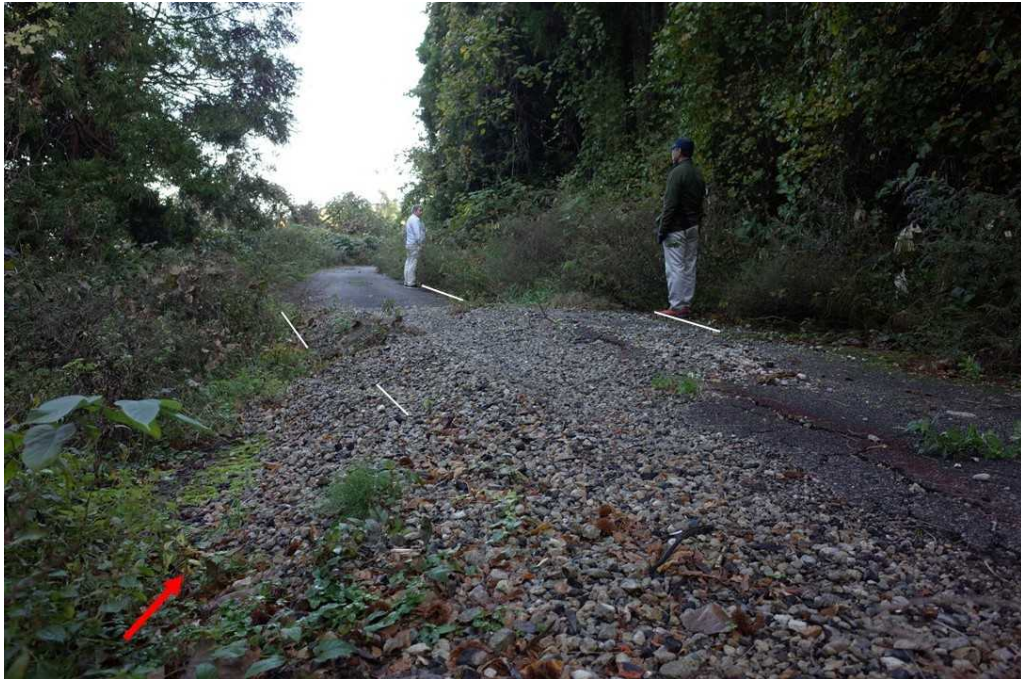
写真2：道路面に確認される左ずれを伴う地震断層（2024年11月10日撮影）
