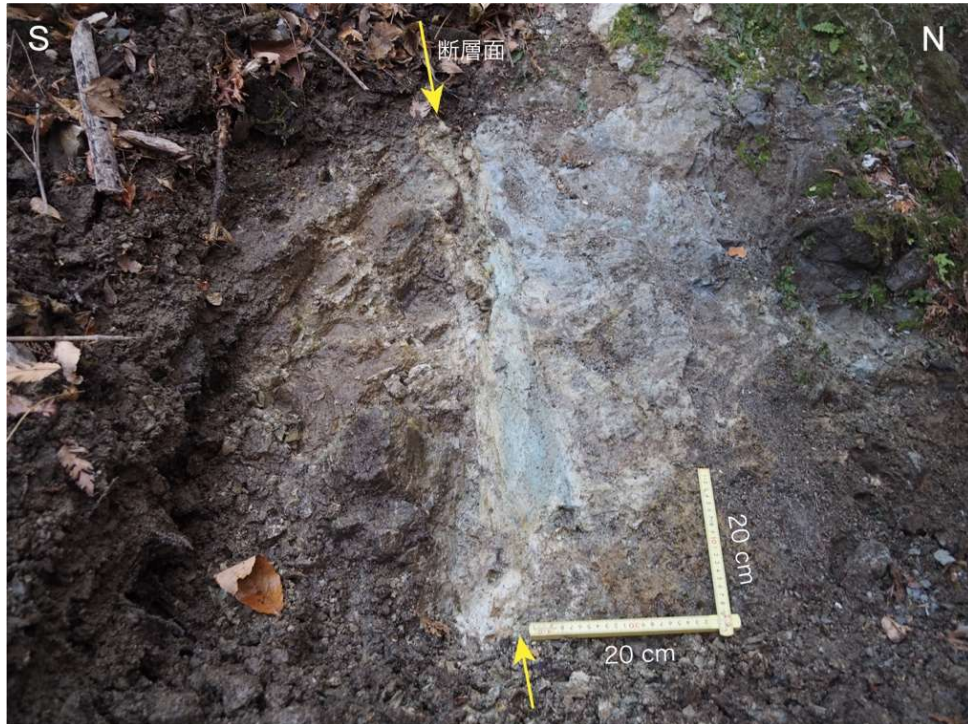
写真10：梅久保付近において確認された断層露頭（2025年2月2日 山中撮影）
