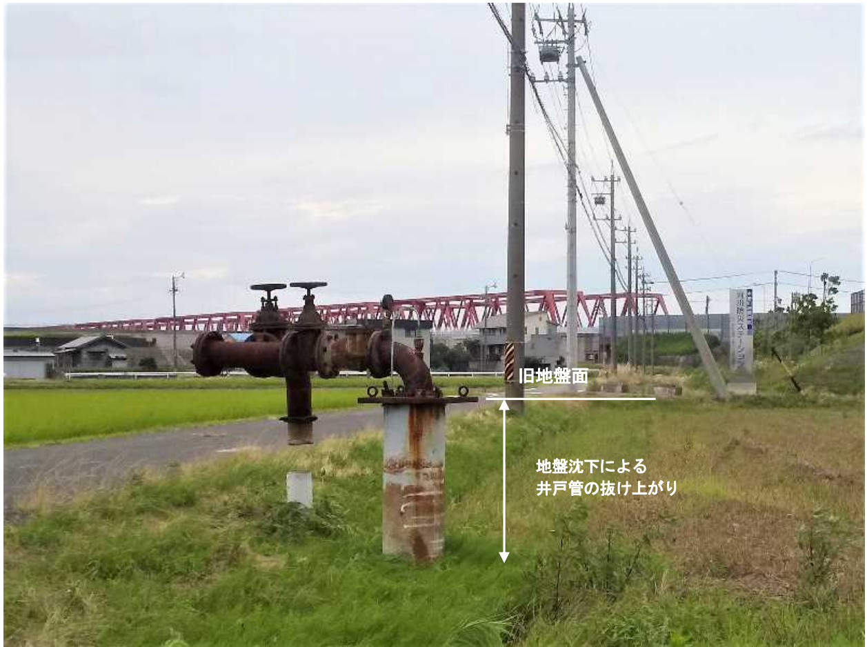
写真-1 三重県桑名郡木曾岬町の井戸管の抜け上がり状況（令和3年6月撮影） ※ 近傍の水準点(C35-9)における累積沈下量：123cm(昭和36年～令和4年)
