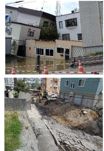
札幌市清田区の液状化被害
