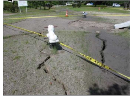
写真2 熊本市内で発生した液状化
