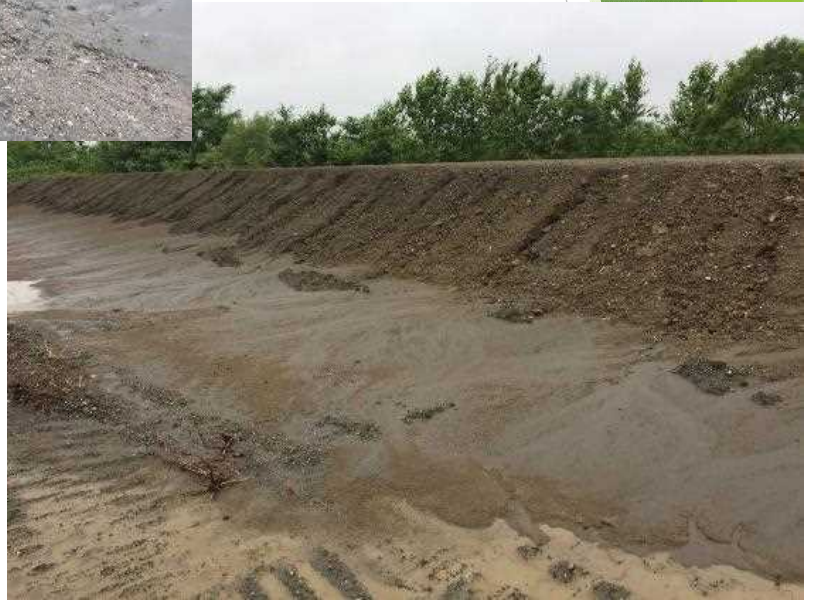
7月16日の豪雨で法面一部流失
