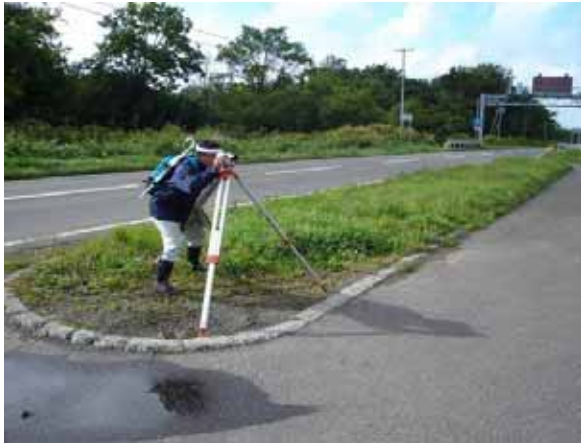
写真 - 3 ベンチマーク設置のための水準測量 (水準点 8630 ~ パンケ水位観測所の間)
