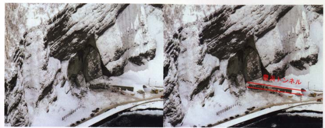
図III-111 1996年2月10日豊浜トンネル岩盤崩落現場。崩落岩体頂部左側付近からつらが垂れ下がっている (1996年2月11日、シン技術コンサル撮影)
