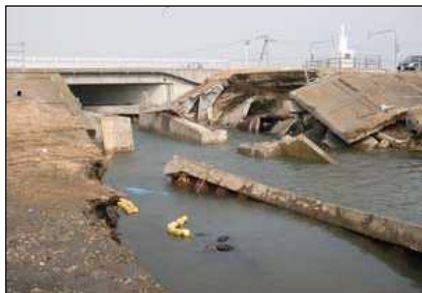
橋梁脇の堤防決壊 (霧多布)
