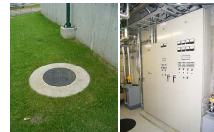
防災井戸とポンプ制御盤
