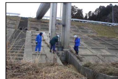
被災状況調査班 (河川樋門の被災状況調査)
