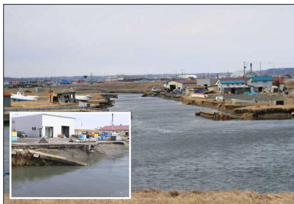
霧多布港 (矢板護岸工の被災状況)
