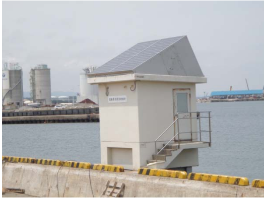
写真-12 福島県相馬港検潮所に設置したソーラーパネル
