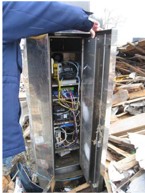
写真-4 電子基準点 020906（田老）収納箱内
