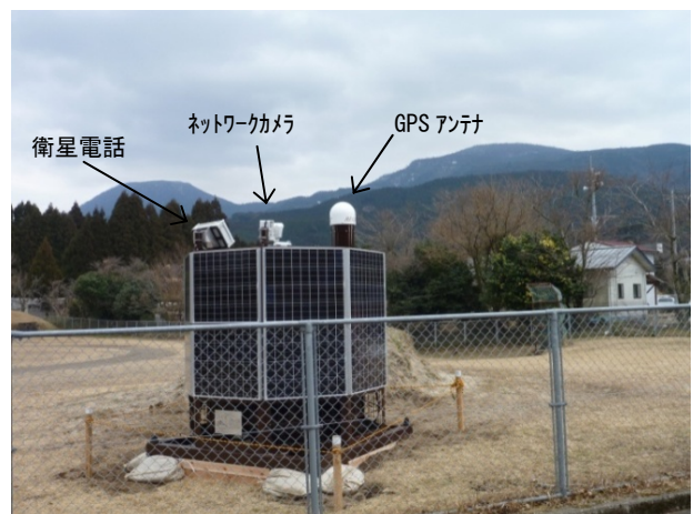
写真-5 設置した REGMOS
