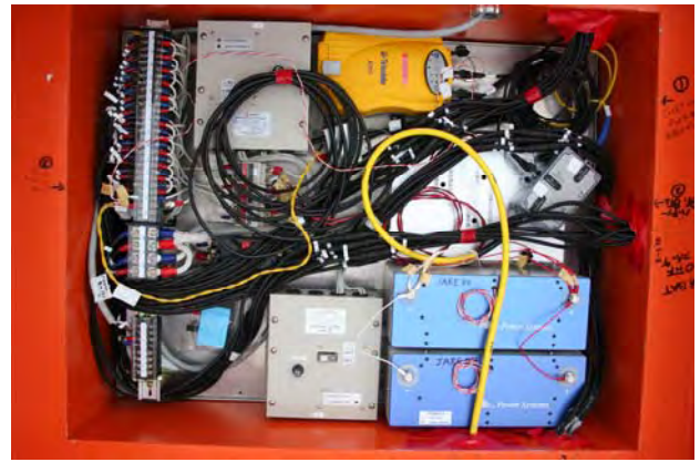
写真-24 GPS 固定観測点ボックス内部 右下の青いボックスがキャパシタ
