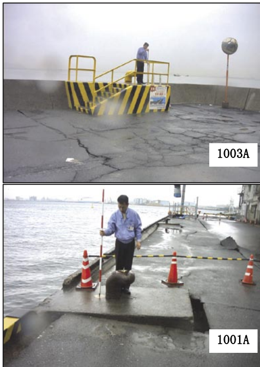
写真-3 街区基準点周辺の被害状況
