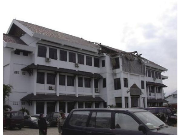
写真-4 バンダアチェ市役所庁舎 地震動により入口部分が崩壊している
