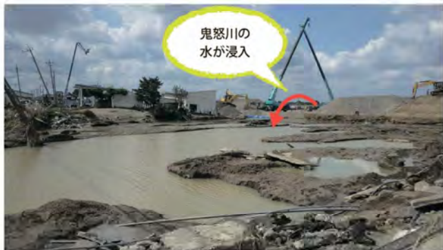
写真 1-11 2015年9月の関東・東北豪雨災害による常総市の堤防決壊現場（奥のクレーン車のあたりが決壊箇所）
