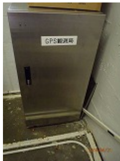
GNSS 観測機器の収納箱
