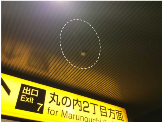
図 20: 設置可能な天井に設置した例
