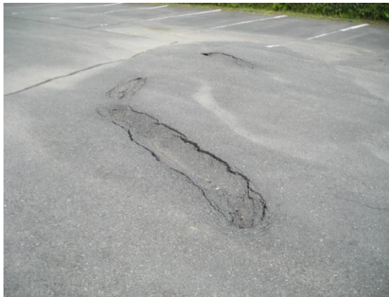
写真4 駐車場での変状
