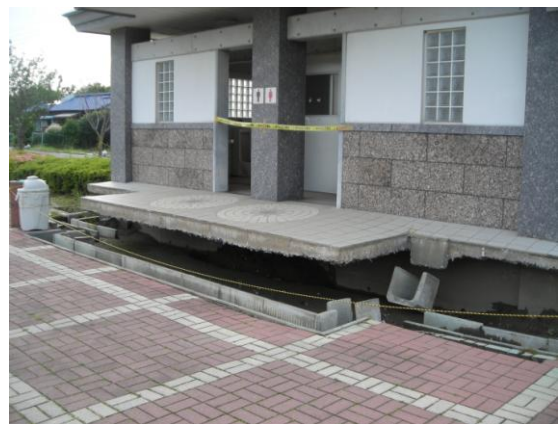
写真5 トイレの抜け上がり (50cm以上)
