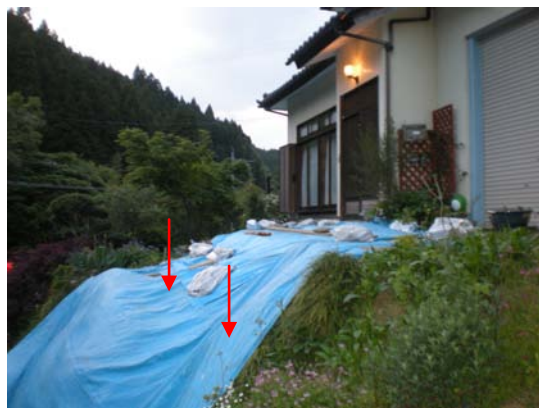
①断層直上でなく見かけ上の被害は小の建物
