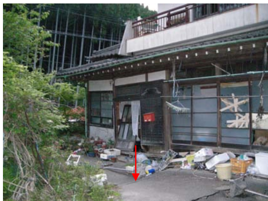
①地点付近の断層直上の被害建物
