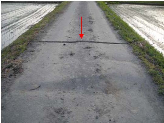
道路にも変状が認められる
