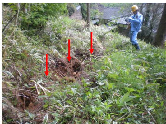
④地点付近の民家の奥に続く段差
