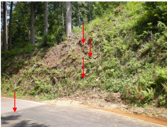
⑭洞坂地区の車道で高低差 20cm 段差有り (改修済) 斜面に亀裂が続き、上方で微妙な高低差有り
