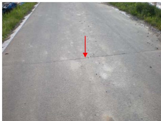
⑱地点の道路上に見られる亀裂
