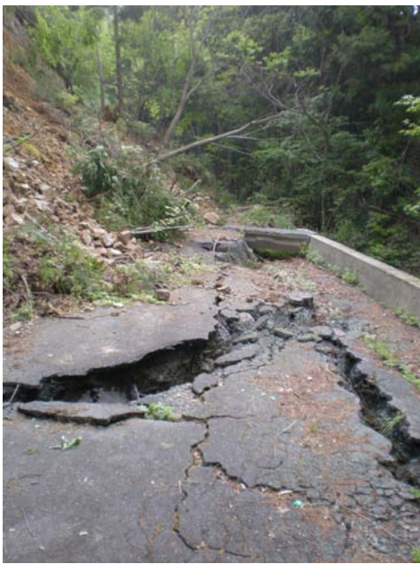
⑬地点の斜面崩壊多発地点 地質は御斎所変成岩 (緑色片岩)
