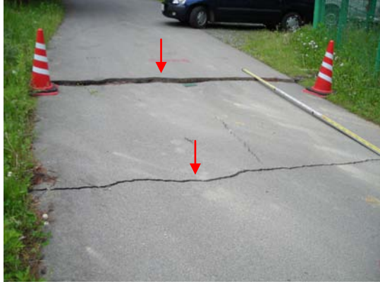
⑧地点の高低差を伴う地盤変状
