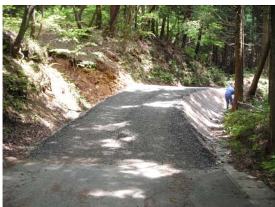
③地点の道路にある 1.5m程度の段差
