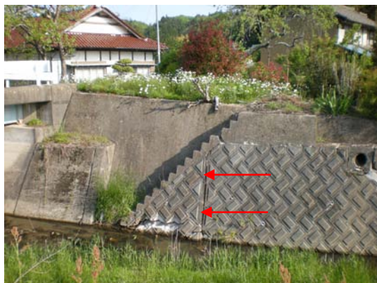
⑳地点の河川護岸に見られる亀裂
