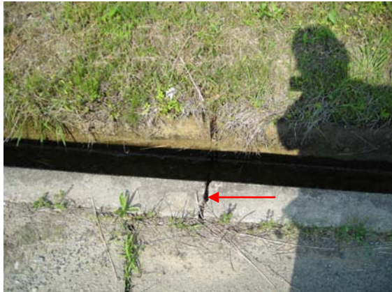
周辺には開口型の亀裂が多い
