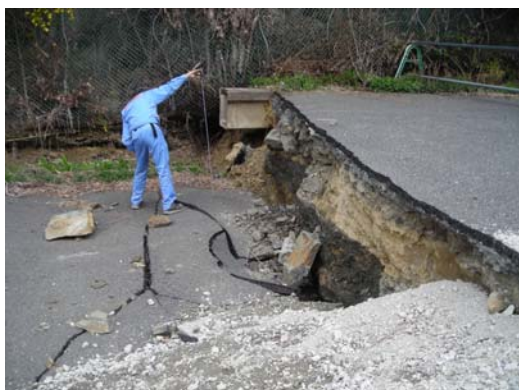
県道 14 号線に西側（写真の左側）約 110cm 低下の断層変位が生じている。写真は南側から撮影。
