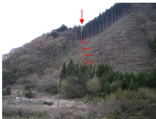
南側の対岸の斜面に、西側（写真の右側）低下の変状（写真の破線部分）が見られる。稜線部（写真の矢印の下部）で、西側（写真の右側）低下の変状が見られる。
