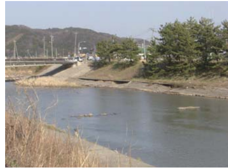
(c) 八ヶ川の堤防の破損
