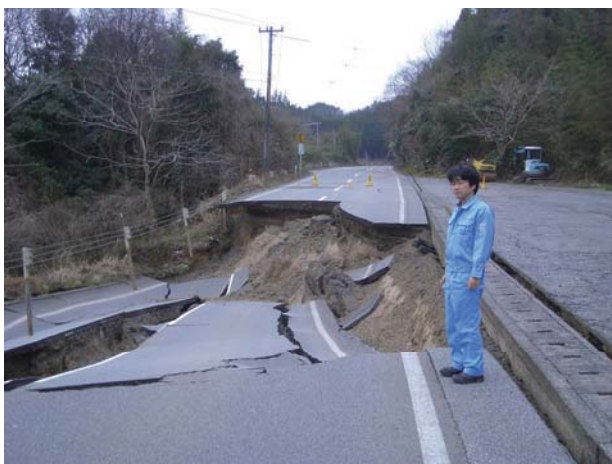
(c) B地点の路面盛土部分の陥没の状況
