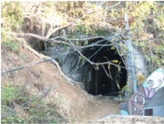
地すべりにより塞がれた羽黒トンネル入り口
