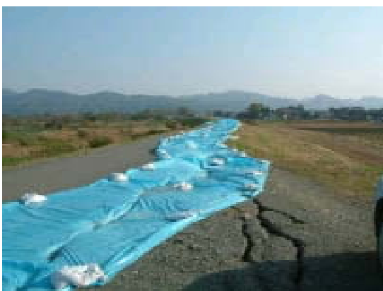
小千谷市五辺付近の信濃川左岸堤防の亀裂
