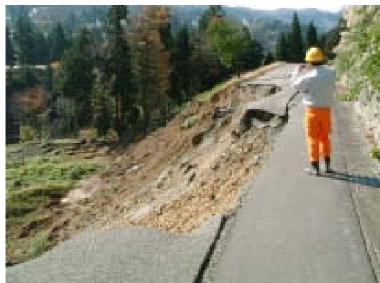
山古志村桂谷の道路崩壊
