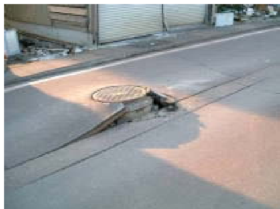
川口町川口のマンホールの抜け上がり
