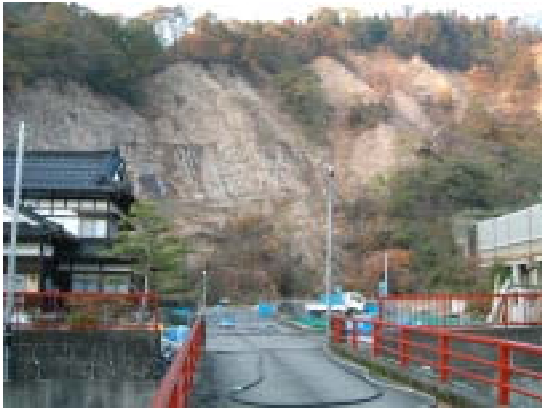
小千谷市浦柄・新幹線トンネル付近の表層崩壊
