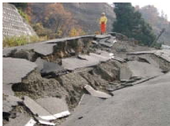
寺野の地すべりによる道路の崩壊
