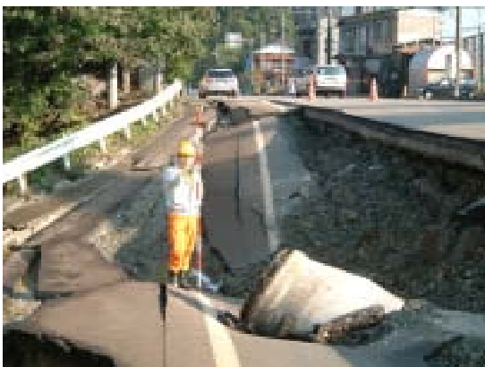
小千谷市ひ生の国道17号道路崩壊
