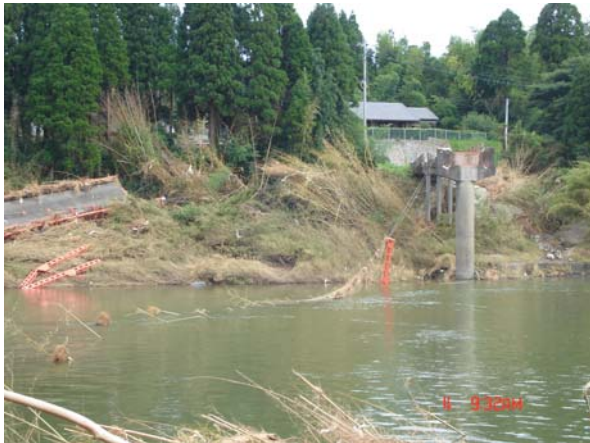
写真-9 落橋した久住橋 （右に残された橋脚，左端に流された橋の一部が見られる）
