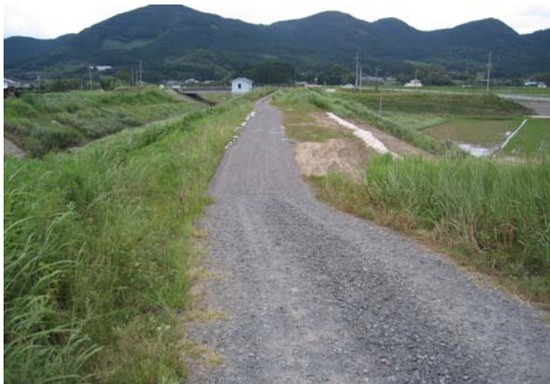
写真-14 桶寄川越水箇所
