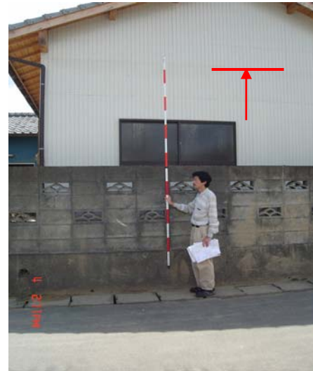
写真-10 住宅の壁の浸水痕
