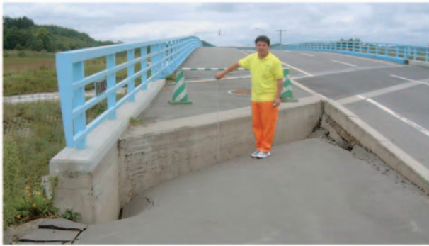
写真－1 歩道部分に段差が生じた橋（豊幌町付近）
