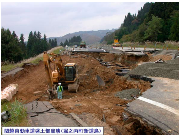
写真－1 関越自動車道盛土部崩壊
