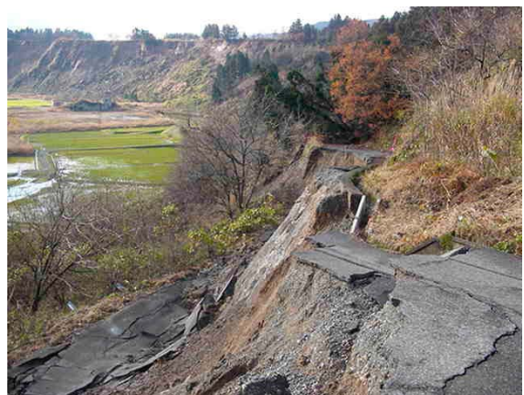
写真-11 崩落で通行不能になった水準路線(十日町市)
