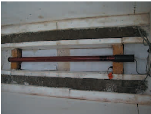
写真-1-2 上図（写真-1-1）ピット内に設置しているインダクション磁力計
